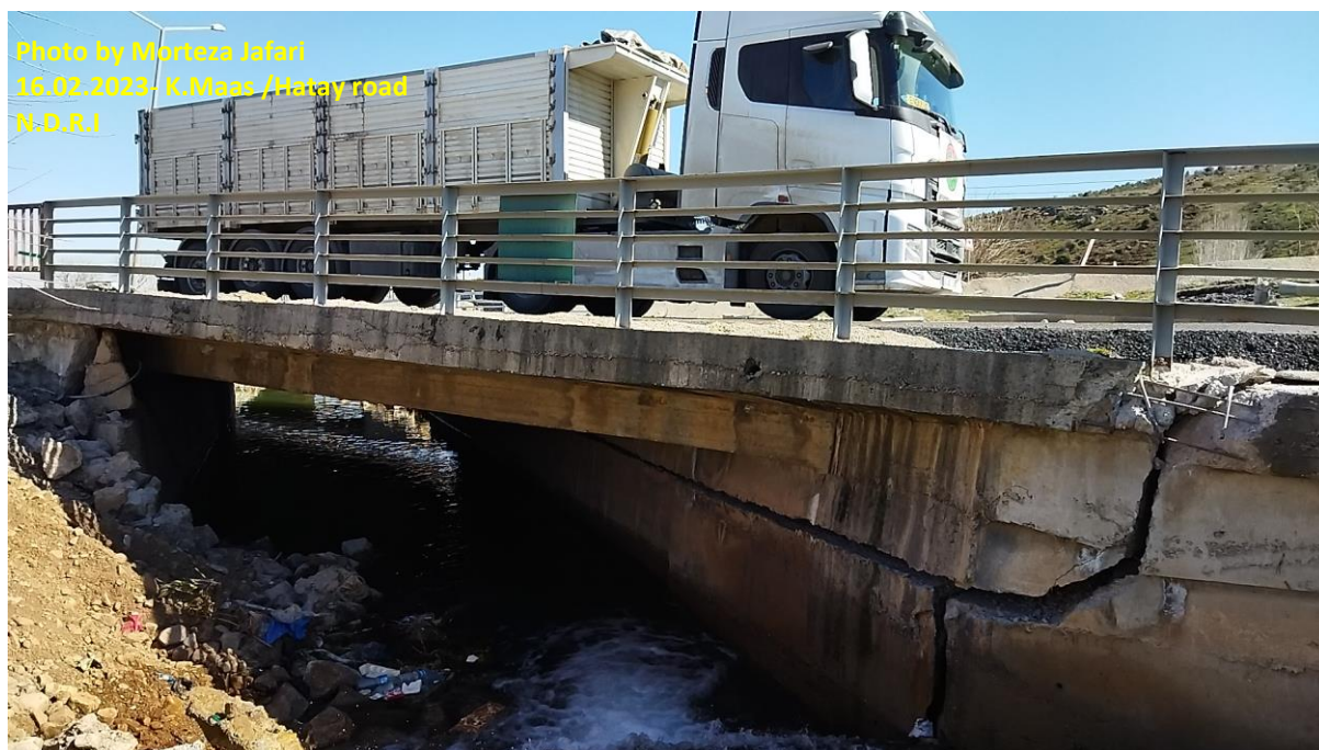
شکل (۱۹): آسیب‌دیدگی کوله پل در جاده قهرمان‌ماراش - حاتای ترکیه
