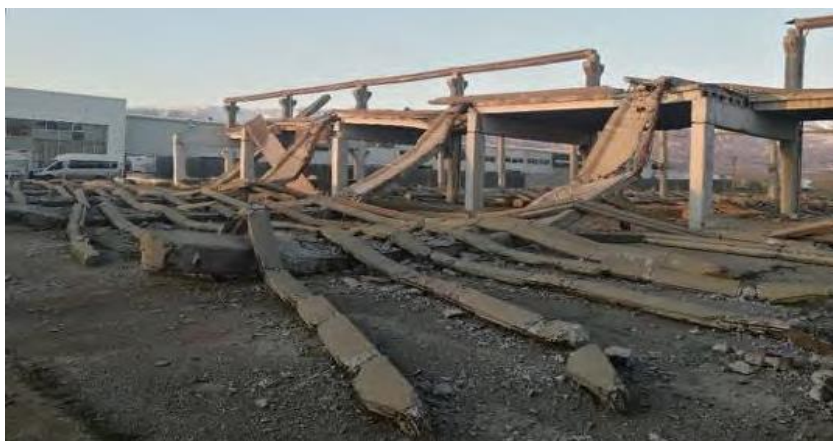
شکل (۱۸): آسیب دیدگی موضعی در بخش نشیمن تکیه‌گاهی و فروریختن تیرهای ساختمان صنعتی
