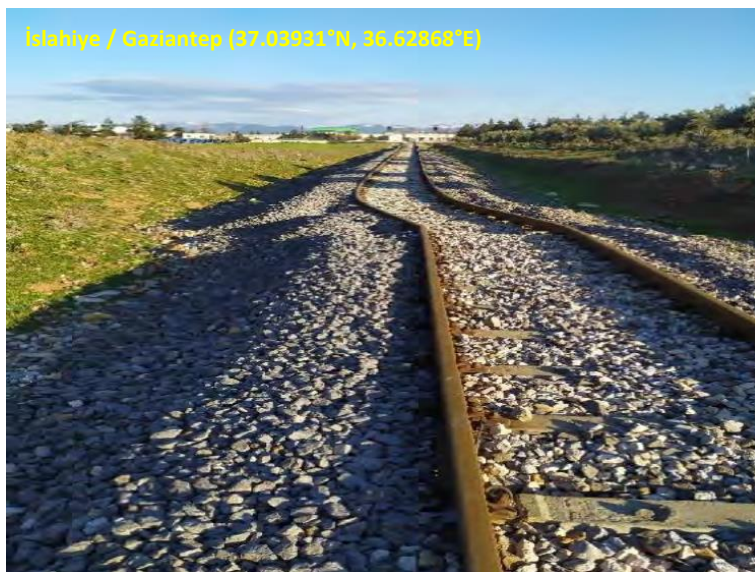
شکل (۲۱): آسیب دیدگی خط راه آهن
