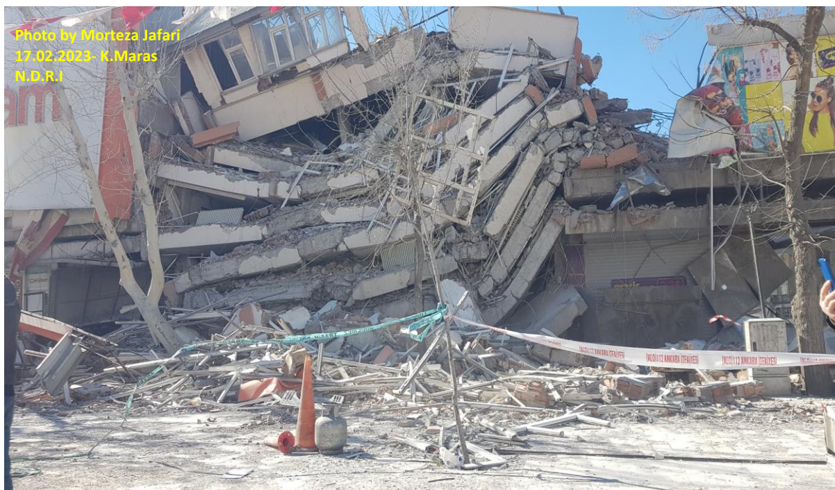
شکل (۱۵): انهدام کامل ساختمان به علت عدم رعایت ضوابط و استانداردهای طرح لرزه‌ای و کیفیت نامطلوب بتن
