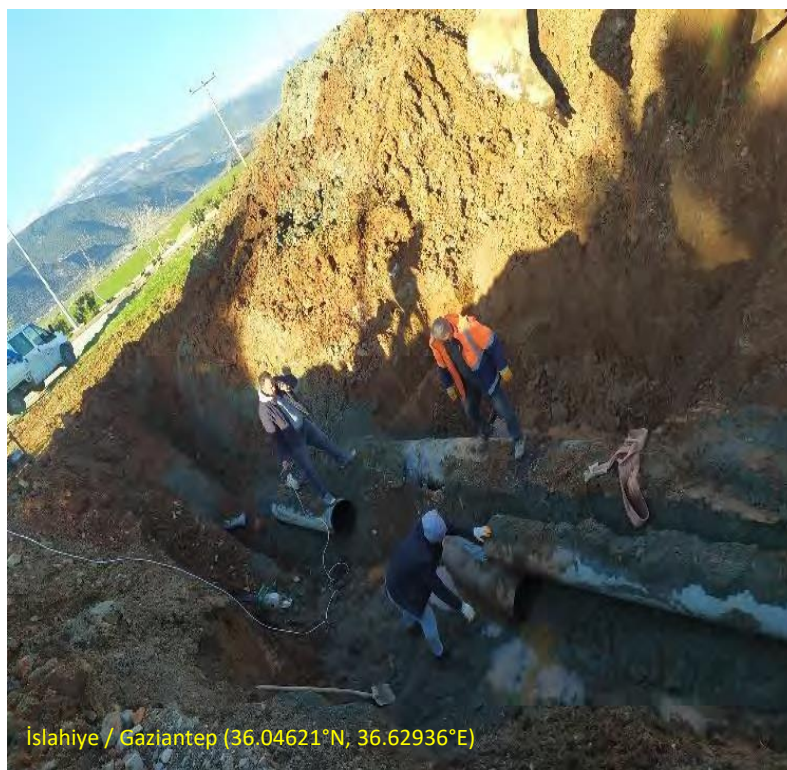
شکل (۲۵): آسیب‌دیدگی خطوط انتقال آب در مسیر غازی‌انتپ - اصلاحیه
