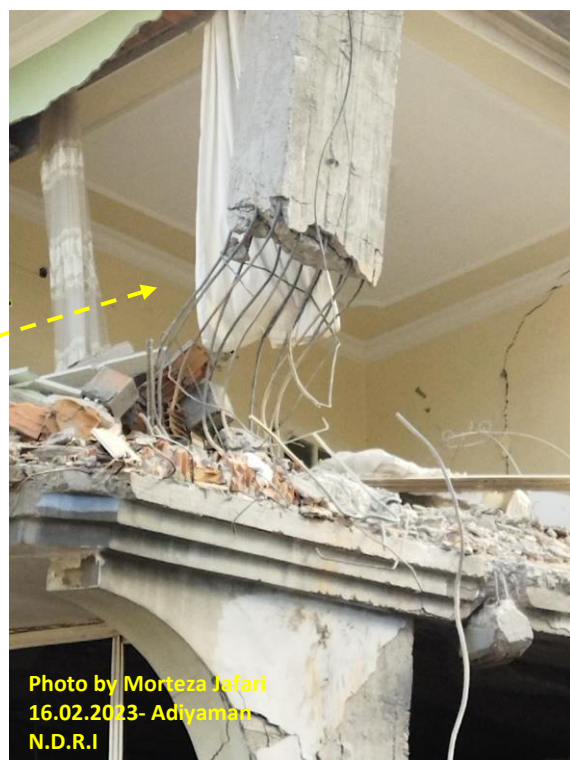
شکل (۱۲): عدم رعایت ضوابط میزان آرماتورهای عرضی و استفاده از آرماتورهای طولی و خاموت صاف و بدون آج
