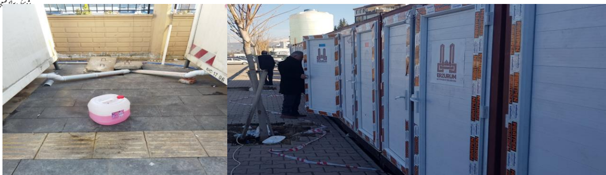
شکل (۲۹): استقرار مناسب سرویس‌های بهداشتی موقت و دفع فاضلاب از طریق سیستم فاضلاب شهری در شهر آدیامان
