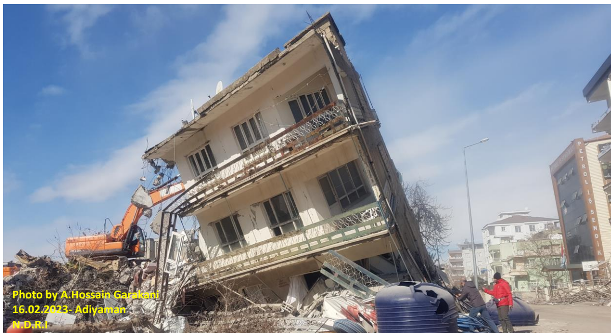
شکل (۹): واژگونی ساختمان به علت کمبود ظرفیت باربری خاک
