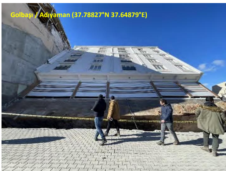
شکل (۱۰): واژگونی ساختمان به علت کمبود ظرفیت باربری خاک و انهدام پی
